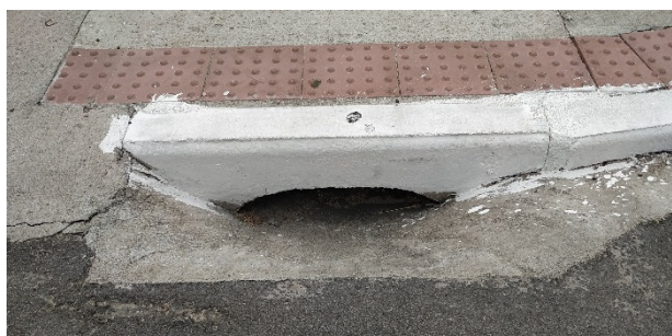
Figura 3 – Boca de Lobo
