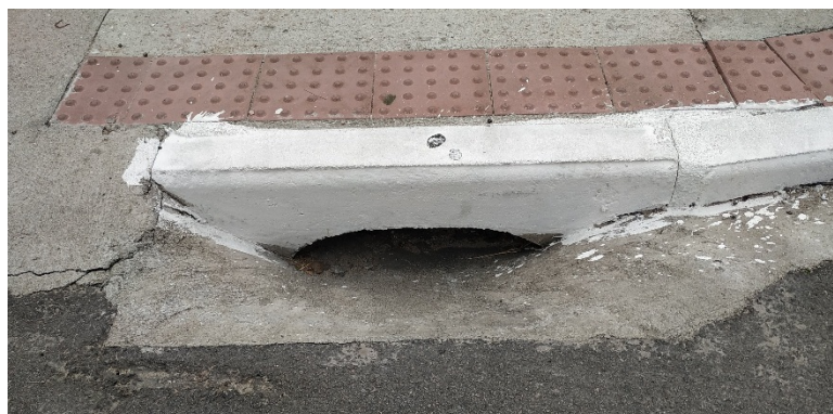
Figura 5 – Boca de Lobo
